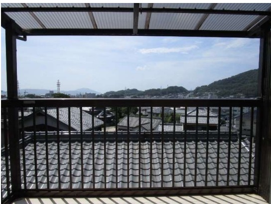
ベランダ 室外洗濯機置き場
