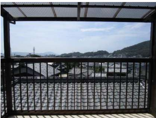
ベランダ 室外洗濯機置き場
