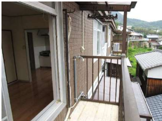
ベランダ 室外洗濯機置き場
